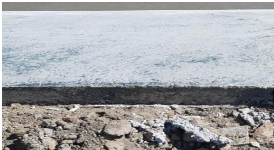
Figura 2 - Calçada com aspecto esverdeado
